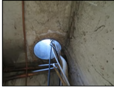
Photo N° 598 AMIANTE CIMENT -- GAINE TECHNIQUE 4 Conduits de fluide Ventilation haute (Fibres- ciment)
