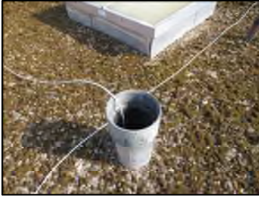
Photo N° 597 AMIANTE CIMENT -- Toiture terrasse Conduits de fluide Ventilation haute (Fibres-ciment)
